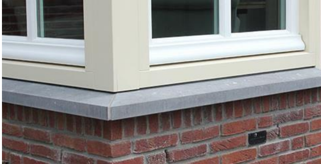
Betondorpels onder de kozijn ( buiten)
